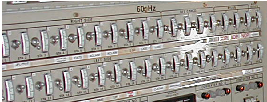
Figure 12. Panel con 34 interruptores.
